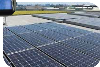
屋上の太陽光発電パネル
